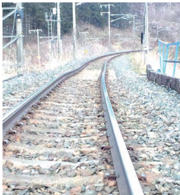
写真 2.7.2 滝沢駅～洪民駅間線路下道床流失状況
