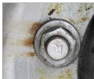
さび汁が流出した痕跡
